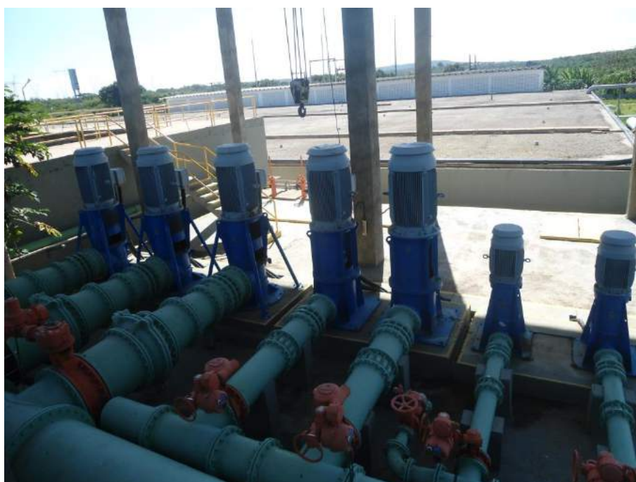
Figura 7.15 – Vista das bombas de lavagem dos filtros da ETA.
