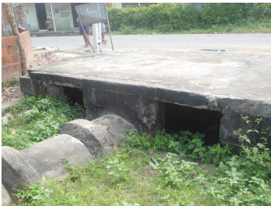
Figura 7.137 – Tubulação de drenagem no Parque Havaí.
