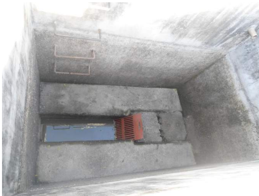
Figura 7.73 – Vista do tratamento preliminar (grade) da estação elevatória EEE-09 (Rua Santo Antônio – Bairro Parque Havaí) do sistema de esgotamento sanitário do Eusébio/CE.
