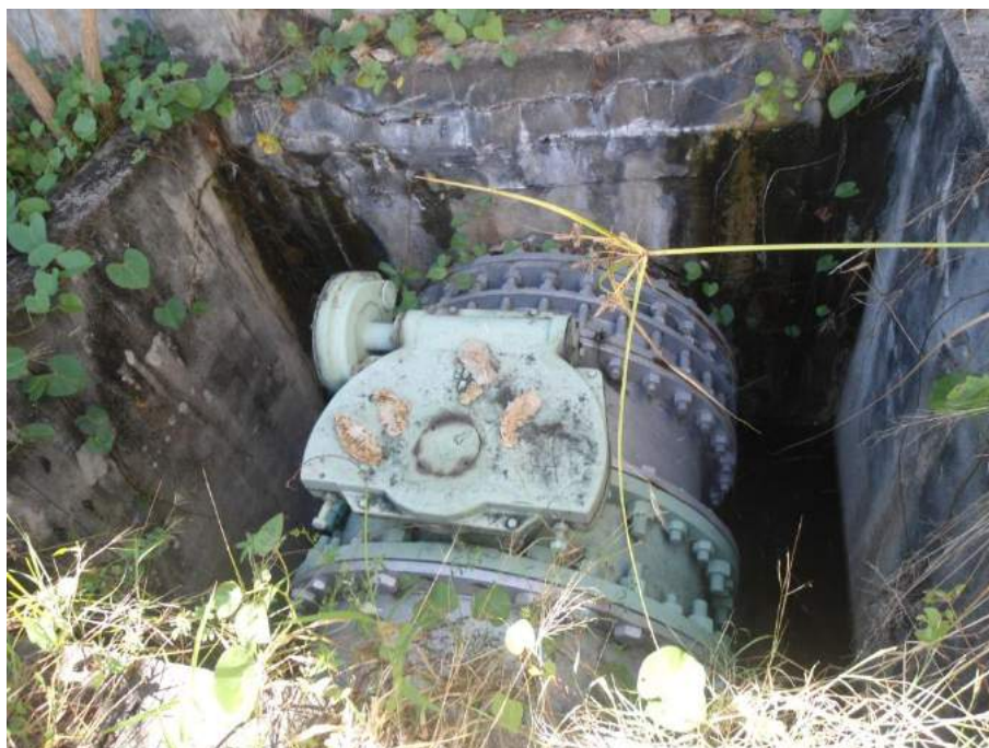
Figura 7.33 – Vista da tubulação de saída do RAP-Ancuri de 80.000 m 3 .
