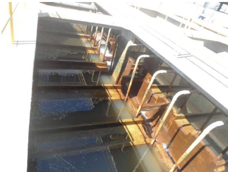
Figura 7.18 – Vista da lavagem dos filtros da ETA.
