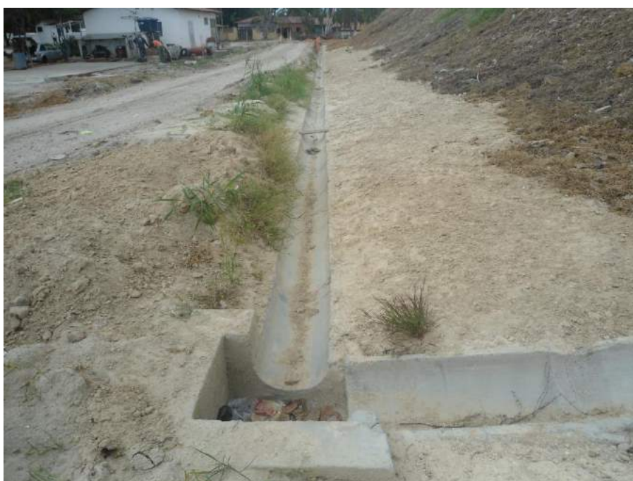
Figura 7.123 – Canaleta de drenagem do Aterro Sanitário Metropolitano Leste (ASML).
