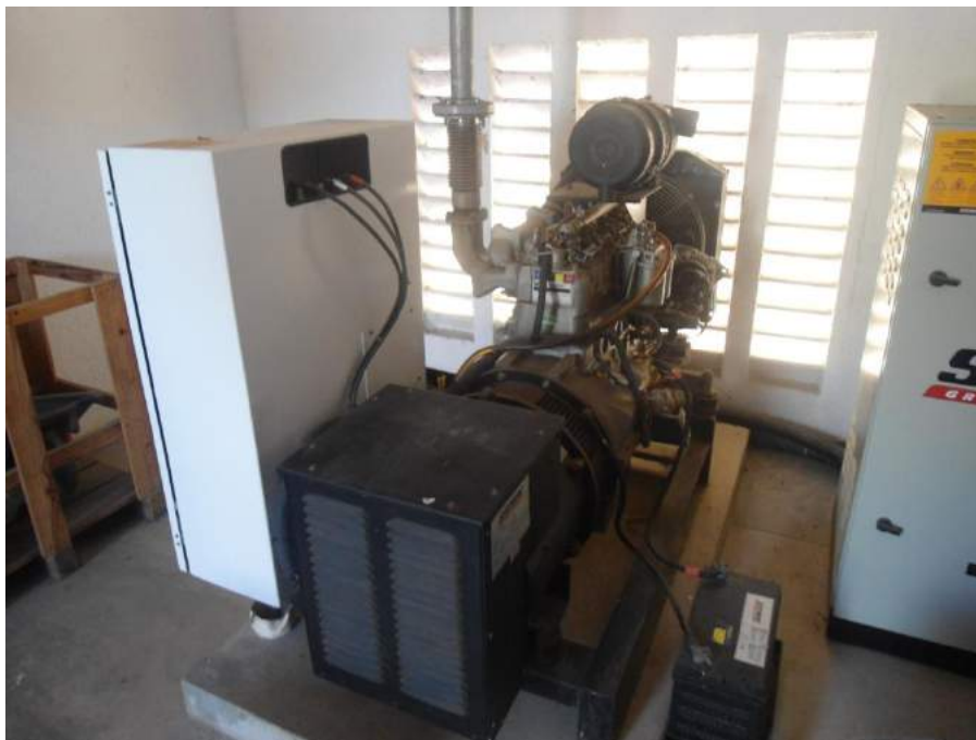
Figura 7.71 – Gerador da estação elevatória EEE-08 (Rua Beira Rio – Condomínio Jardim Ibiza) do sistema de esgotamento sanitário do Eusébio/CE.
