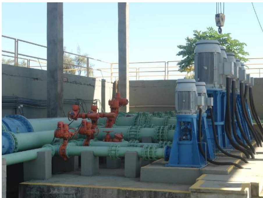
Figura 7.16 – Vista das bombas de lavagem dos filtros da ETA.
