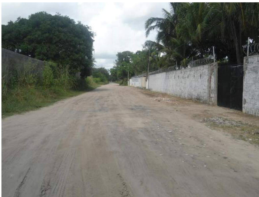
Figura 7.142 – Rua se pavimentação.
