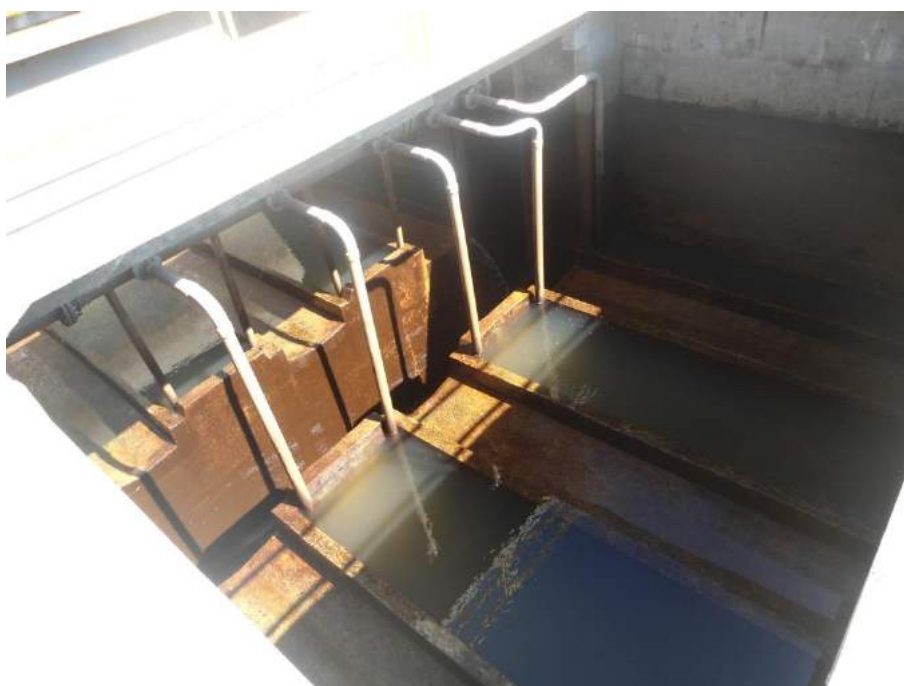
Figura 7.17 – Vista da lavagem dos filtros da ETA.
