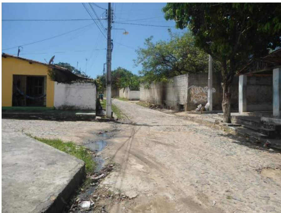
Figura 7.43 – Esgoto a céu aberto no bairro Precabura.
