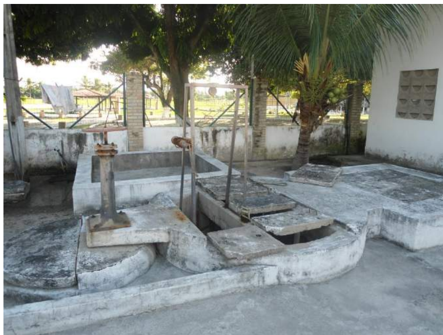
Figura 7.60 – Vista do poço de sucção da estação elevatória EEE-07 (Rua Irmã Ambrosina – Bairro Centro) do sistema de esgotamento sanitário do Eusébio/CE.
