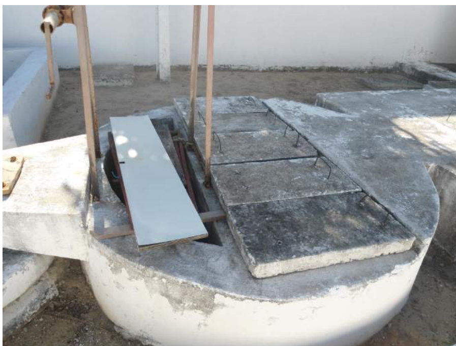
Figura 7.54 – Vista do poço de sucção da estação elevatória EEE-03 (Rua José Bento – Bairro Guaribas) do sistema de esgotamento sanitário do Eusébio/CE.
