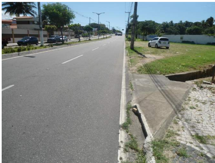
Figura 7.130 – Dispositivo de drenagem (boca de lobo) na Av. Eusébio de Queiróz.
