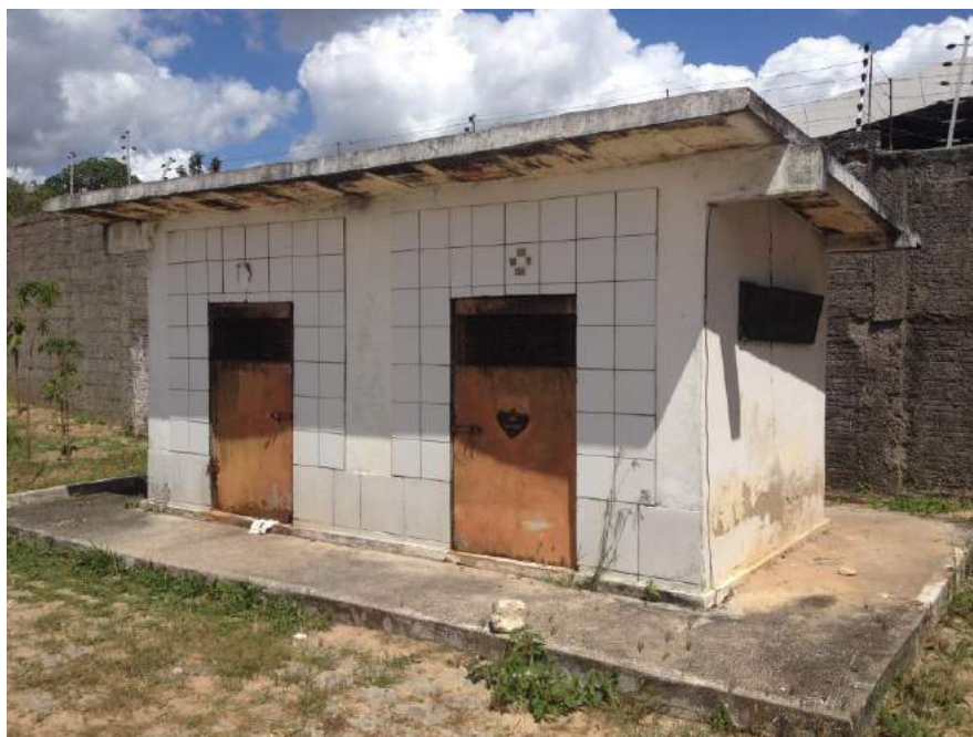
Figura 7.111 – Abrigo temporário para acondicionamento de RSS (Porta à Direita).
