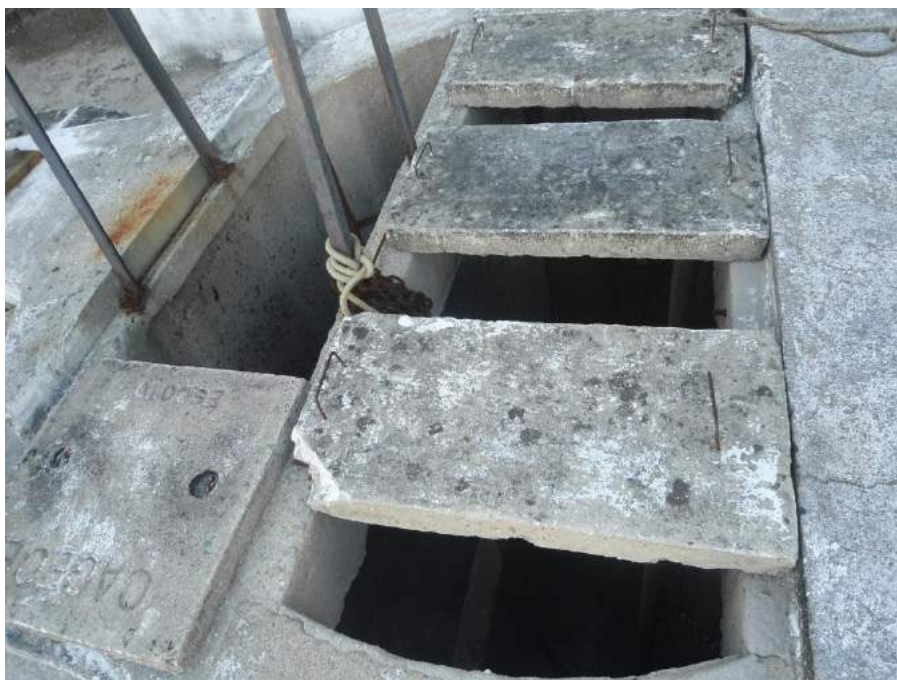
Figura 7.61 – Vista do poço de sucção da estação elevatória EEE-07 (Rua Irmã Ambrosina – Bairro Centro) do sistema de esgotamento sanitário do Eusébio/CE.
