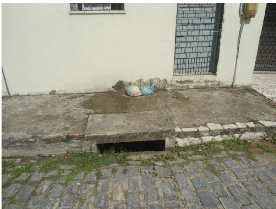
Figura 7.135 – Dispositivo de drenagem (boca de lobo) na Rua Irmã Ambrosina.
