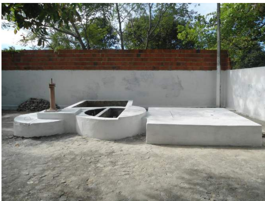
Figura 7.46 – Vista do poço de sucção da estação elevatória EEE-02 (Rua Acilon Gonçalves – Bairro Guaribas) do sistema de esgotamento sanitário do Eusébio/CE.
