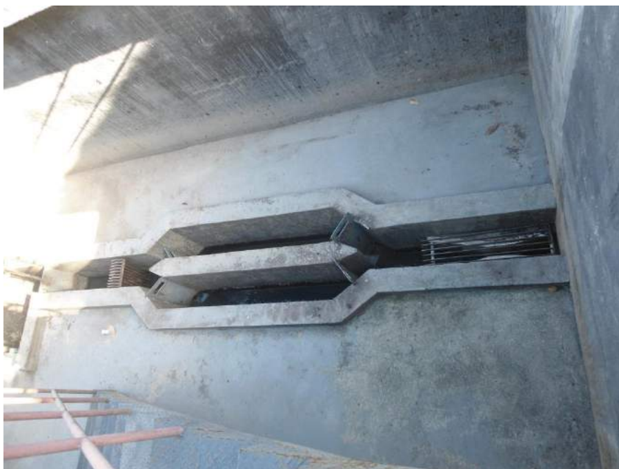
Figura 7.66 – Vista do tratamento preliminar (grade e caixa de areia) da estação elevatória EEE-08 (Rua Beira Rio – Condomínio Jardim Ibiza) do sistema de esgotamento sanitário do Eusébio/CE.
