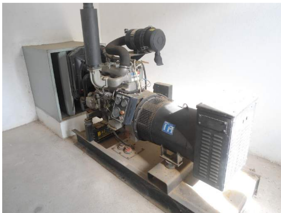
Figura 7.50 – Gerador da estação elevatória EEE-02 (Rua Acilon Gonçalves – Bairro Guaribas) do sistema de esgotamento sanitário do Eusébio/CE.
