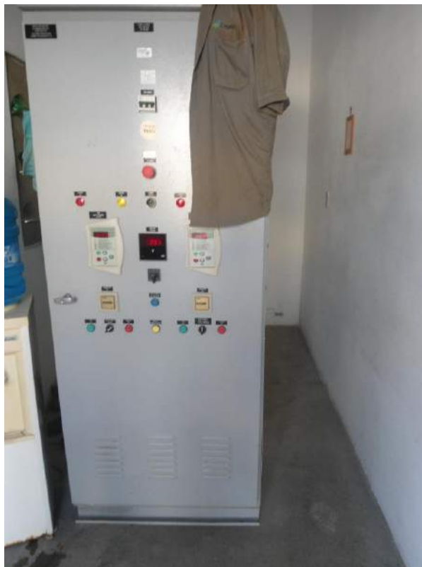
Figura 7.63 – Quadro de comando da estação elevatória EEE-07 (Rua Irmã Ambrosina – Bairro Centro) do sistema de esgotamento sanitário do Eusébio/CE.
