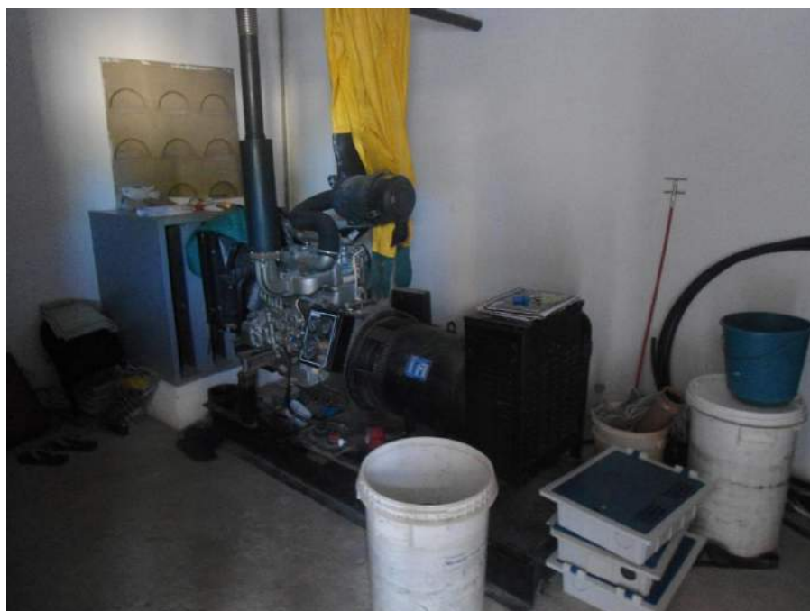
Figura 7.64 – Gerador da estação elevatória EEE-07 (Rua Irmã Ambrosina – Bairro Centro) do sistema de esgotamento sanitário do Eusébio/CE.
