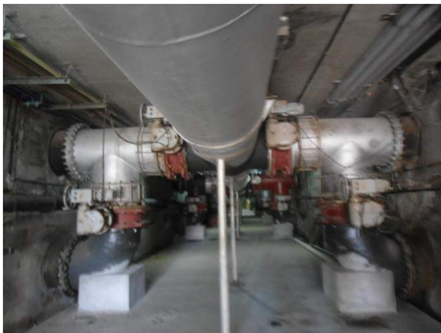
Figura 7.12 – Vista da tubulação interna da ETA.
