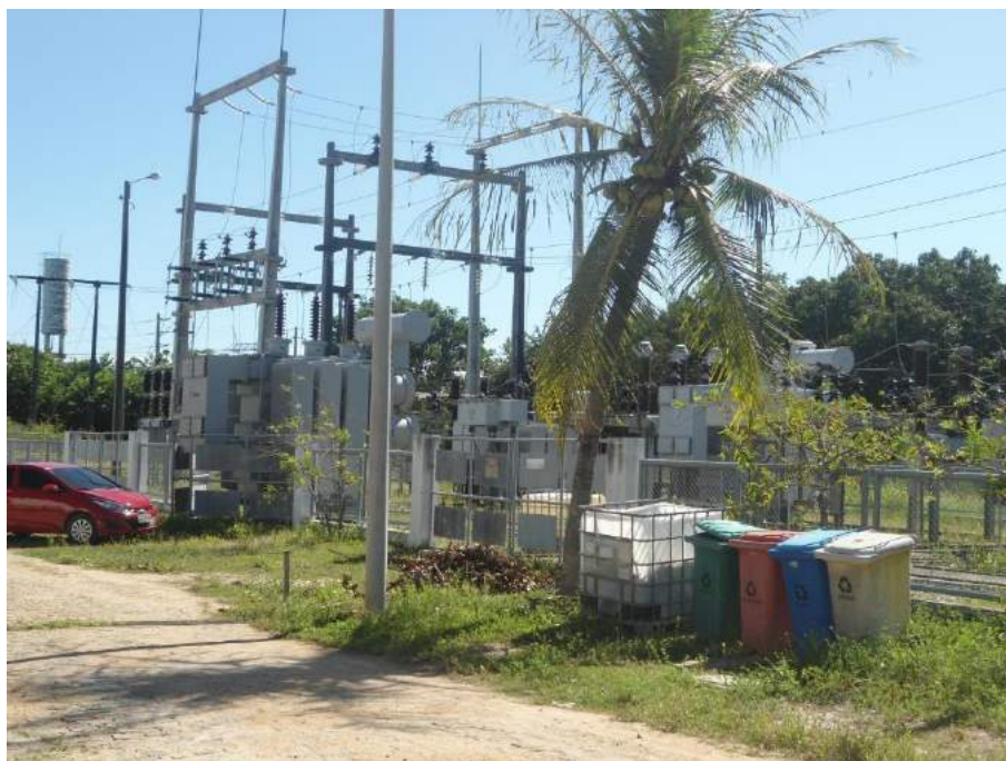
Figura 7.22 – Vista da sub-estação da ETA.
