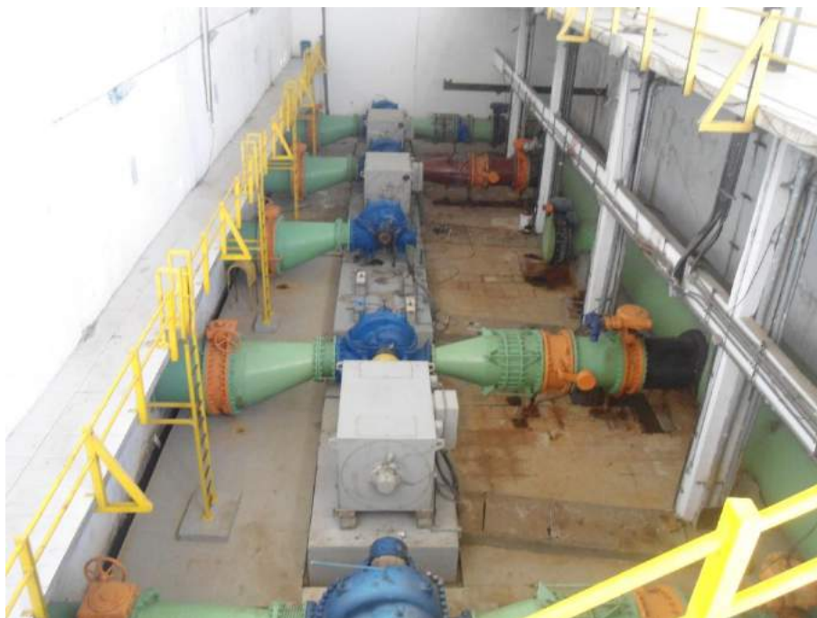
Figura 7.25 – Vista das bombas da estação elevatória de água tratada da ETA.
