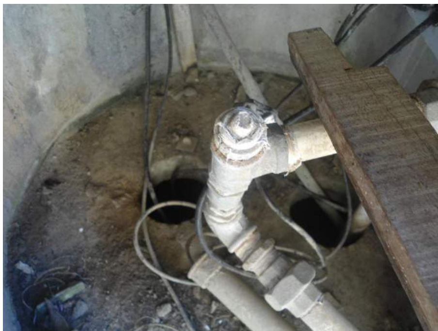
Figura 7.35 – Vista do poço no bairro Olho D'Água.
