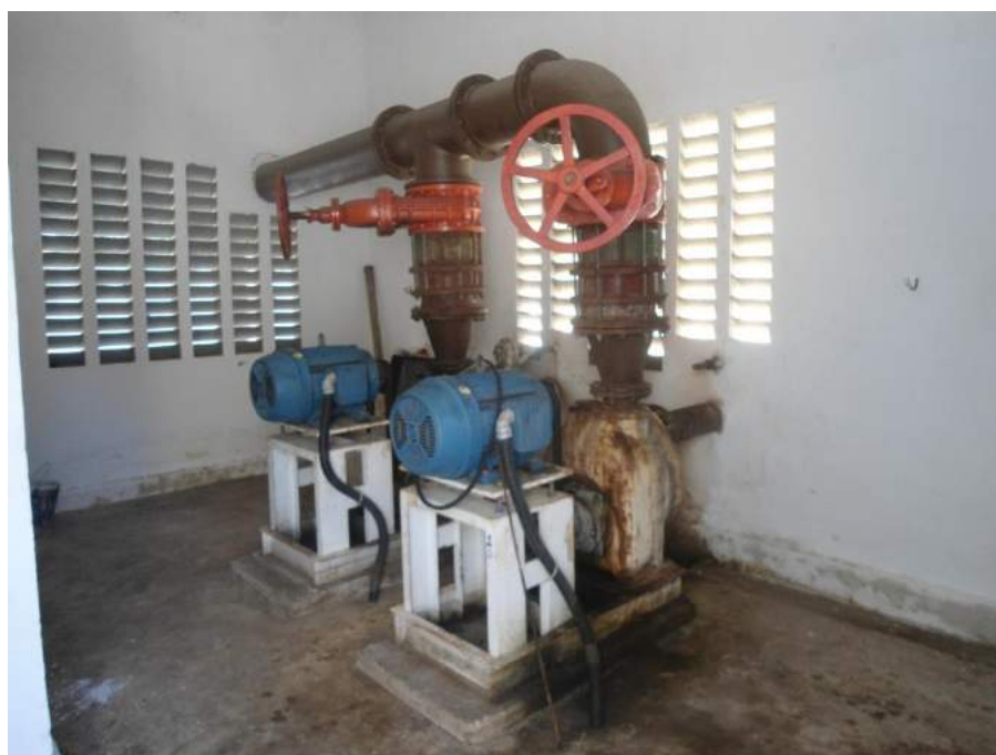
Figura 7.82 – Bombas da estação elevatória EEE-10 (Rua Wilson Milfhon – Bairro Alagoinha) do sistema de esgotamento sanitário do Eusébio/CE.
