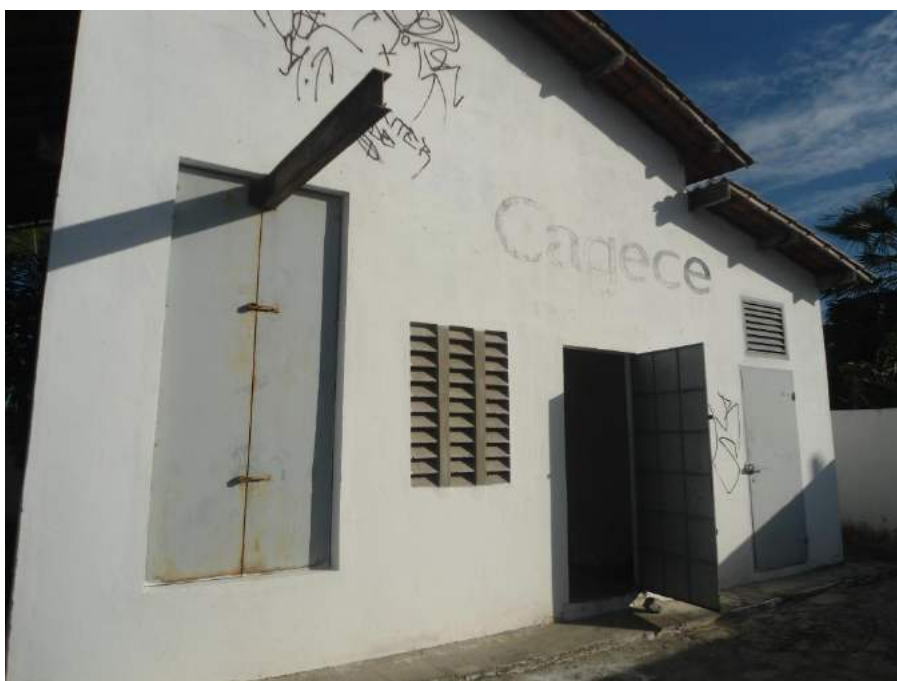
Figura 7.76 – Vista da casa do quadro de comando/bombas da estação elevatória EEE-09 (Rua Santo Antônio – Bairro Parque Havaí) do sistema de esgotamento sanitário do Eusébio/CE.
